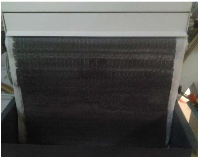
Bandfilter mit benutztem Filtertuch, vor der Reinigung des Tiefbohröls
