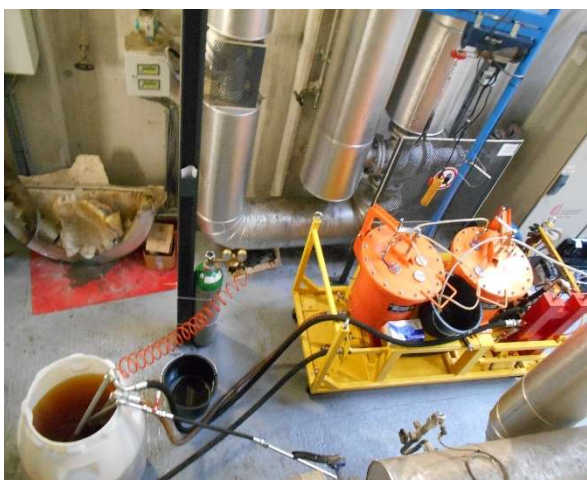
Aufbau der Filteranlage mit einem Behälter des ungereinigten Silikonöls.
