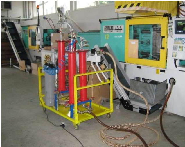
Reinigung einer Spritzgussanlage inkl. Schläuche, Zylinder usw., sowie des Hydrauliköls ISO VG HLP 46
